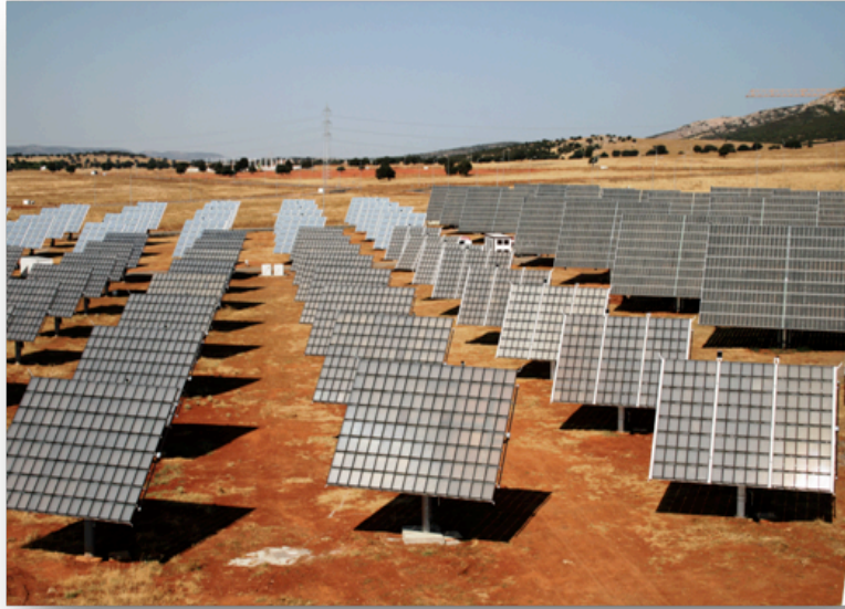
Figura 15. Prueba en funcionamiento real de tecnologías de concentración. Cortesía de ISFOC.
